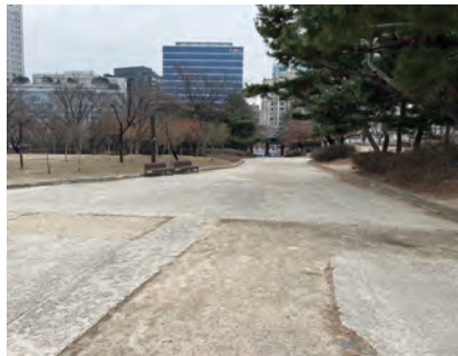
궁궐 진입부 노후 포장 및 식재 (공사전)
