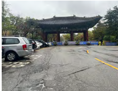
경희궁 진입부 노후 바닥 포장 (공사전)
